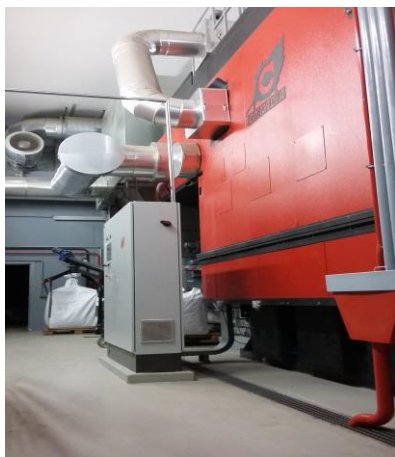
La chaudière biomasse
